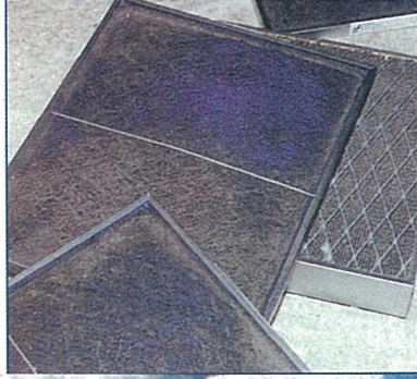
Çevre kontrol sistem hasarı.
