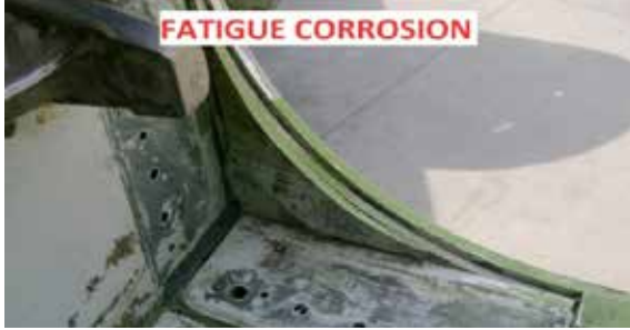
Şekil 8: Lokasyon: Emergency Door lower cutout Sebebi: Uçağın yaşına da bağlı olarak F/C yüksek olmasından dolayı yorulma ömrünün azalması.
