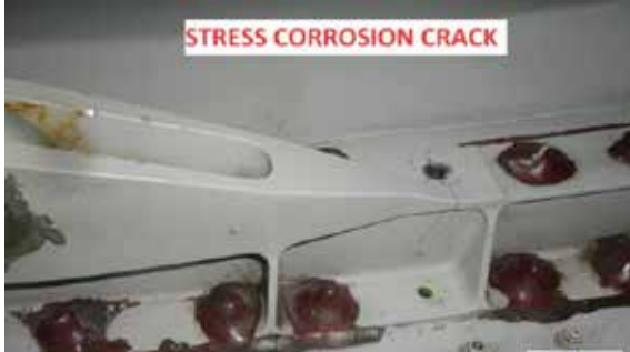
Şekil 9: Lokasyon: Ana İniş Takım Kapağı (MLG door) Sebebi: Kapağın ayarsız takılması akabinde yaşadığı sürekli stress den dolayı çatlak meydana gelmiş ve korozyona dönüşmüştür.
